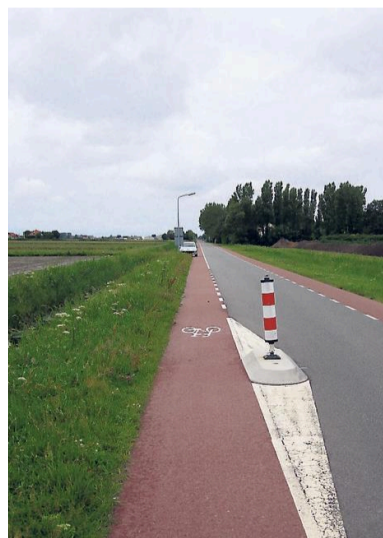
Een van de gewraakte paaltjes op de Balgweg en het fietspad langs het Balgzandkanaal.
