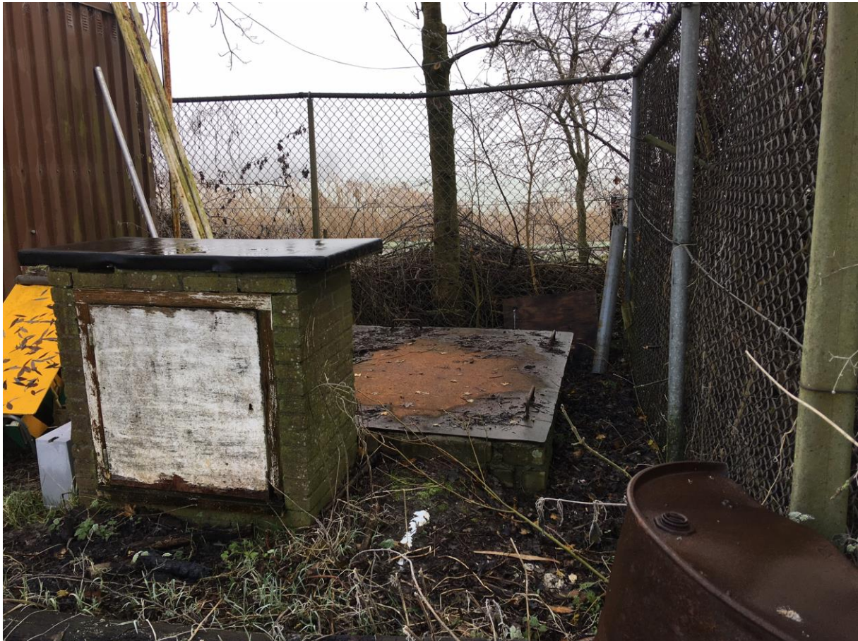
Afbeelding 4: de pompvoorziening van de ijsbaan, naast de containers
